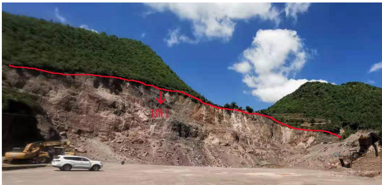
照片 3-1 露天采场西北部不稳定斜坡 BW_1
