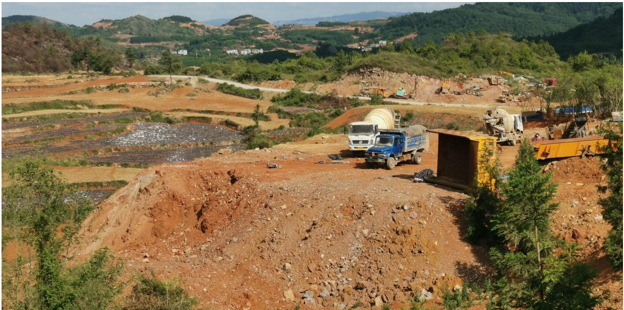
照片 4-1 已损毁土地剥离表土堆存情况
